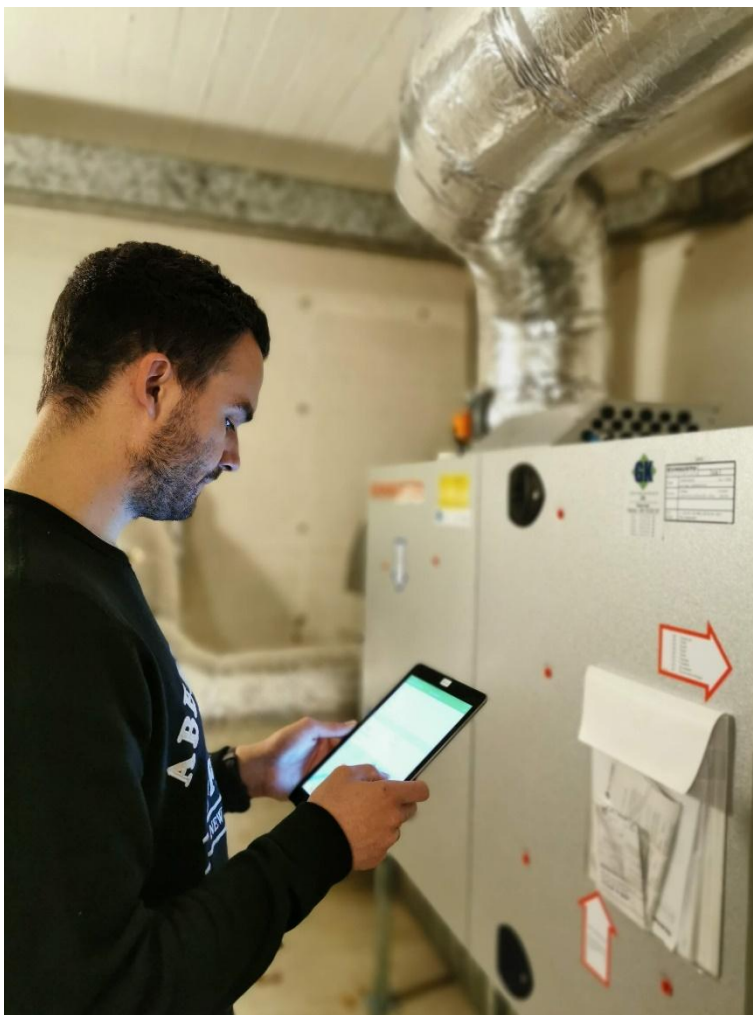
[Img 13 Opérateur de maintenance.
